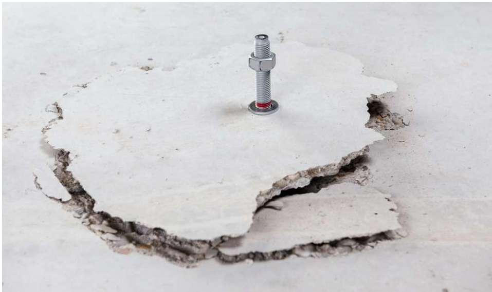
Otkaz betona – zatezanje / čupanja
