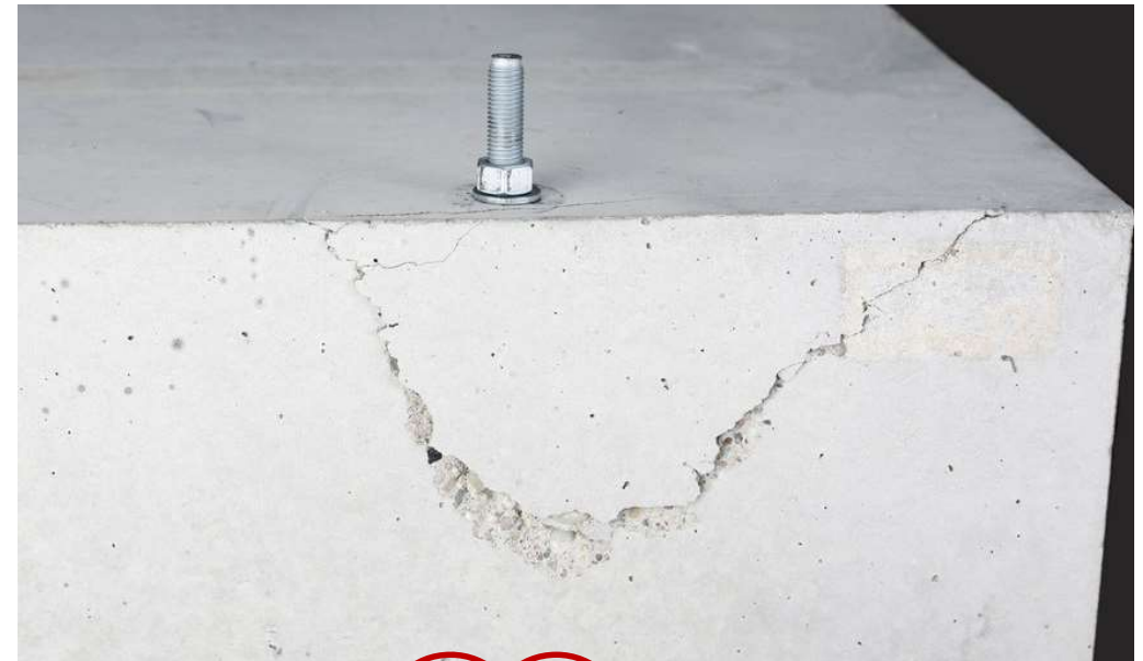
Otkaz betona - smicanja
